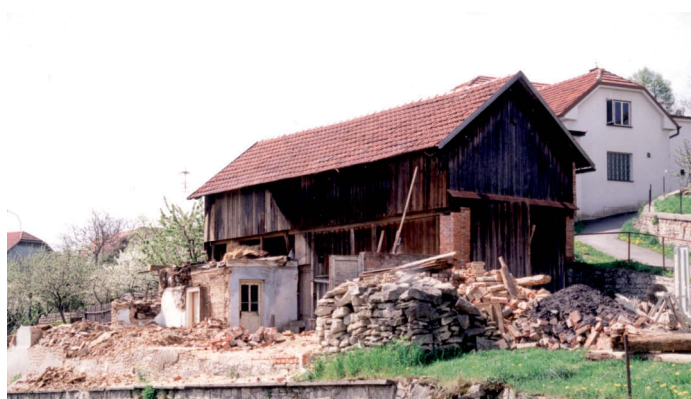
Zbořeniště chalupy č. 38 v r. 2002 v D.Ú.
